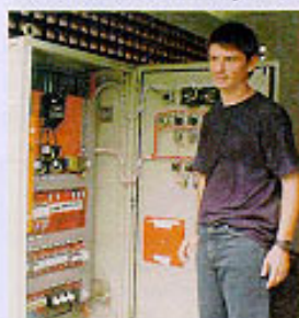
O operador Paulo César Lopes controla o sistema pelo painel elétrico.
