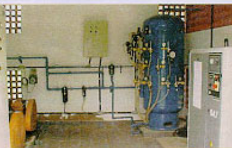
Na Casa das Máquinas dois painéis elétricos comandam o funcionamento das bombas e do compressor.
